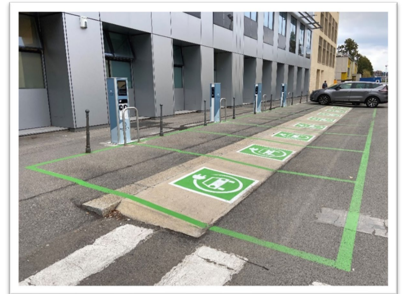
Stazioni di ricarica a colonnina presso l'edificio 20
